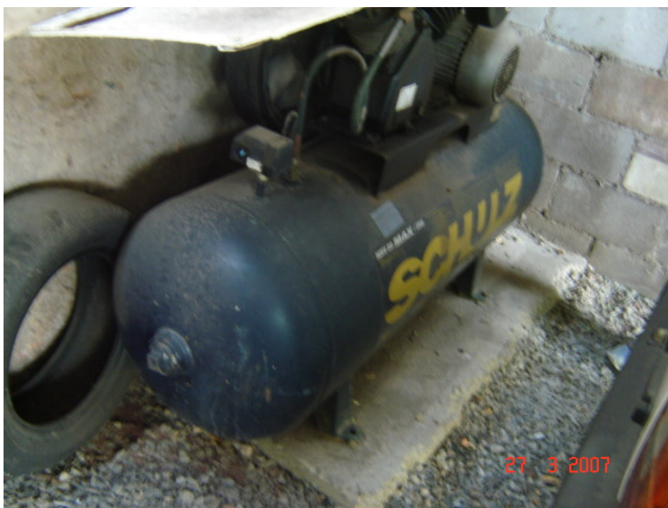
Fig. 3.1 - Compressor de ar
